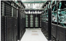
Unico Il data center del Centro Europeo per le previsioni a medio termine
